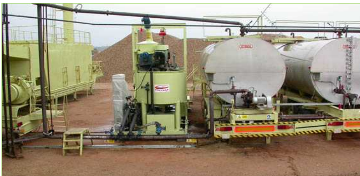
Detalle mezclador de polvo de neumático instalado en planta MBC
