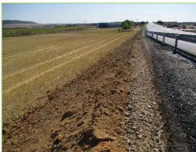
Vista de la tierra vegetal extendida sobre el talud de un terraplén de nueva construcción
